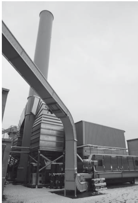
Das Herz der Anlage: das Kesselhaus
